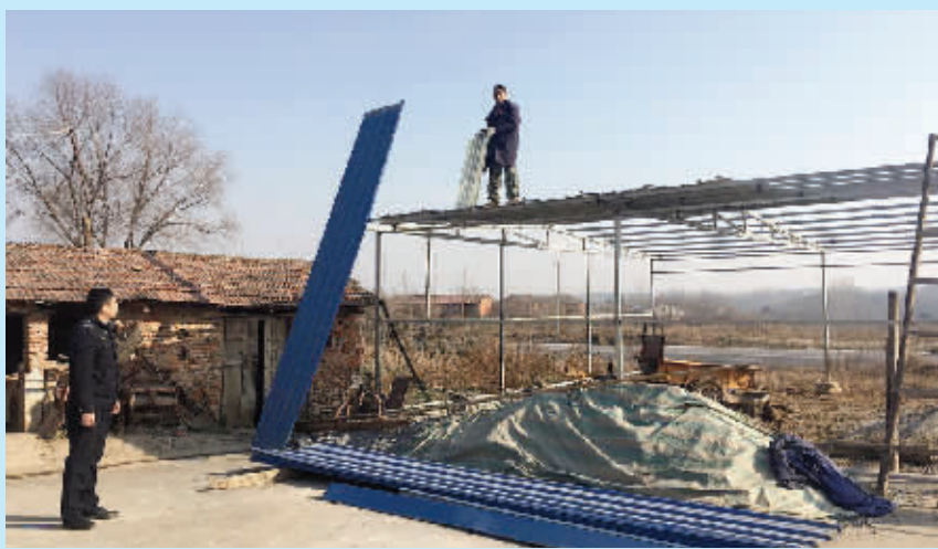
1日,东宝区控违办组织牌楼镇政府、区城管执法局对牌楼镇牌楼村五组一处违法搭建的活动板房进行了拆除,拆除面积约180平方米。荆门晚报通讯员 龙振华 摄
